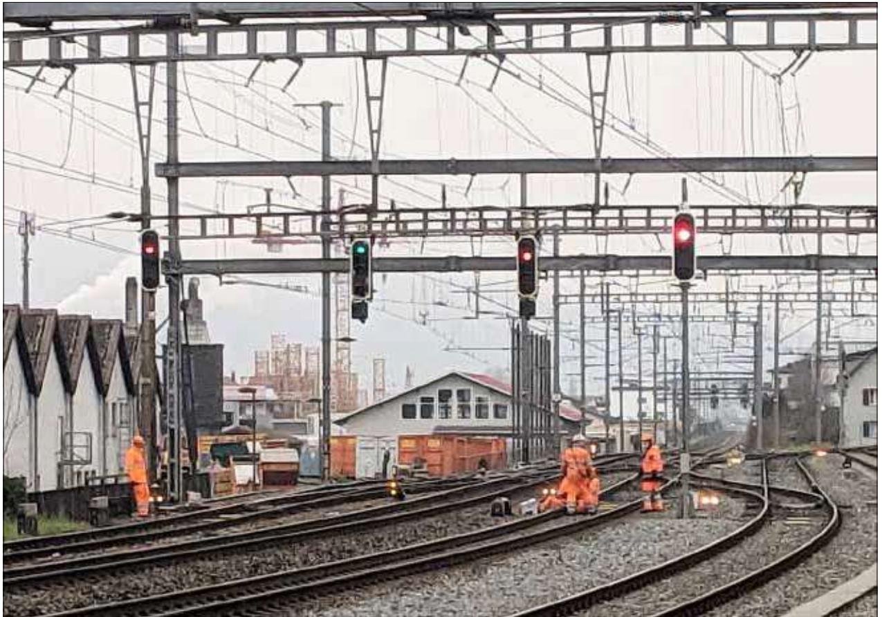
Störungsbehebung beim Bahnhof Zofingen anfangs Dezember 2020. Beteiligt waren insgesamt 9 Personen, von BAKOM, den SBB und dem Lieferanten der Zugsicherungsanlage.
