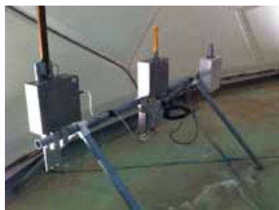
Figure 1: Installation à la Dôle
