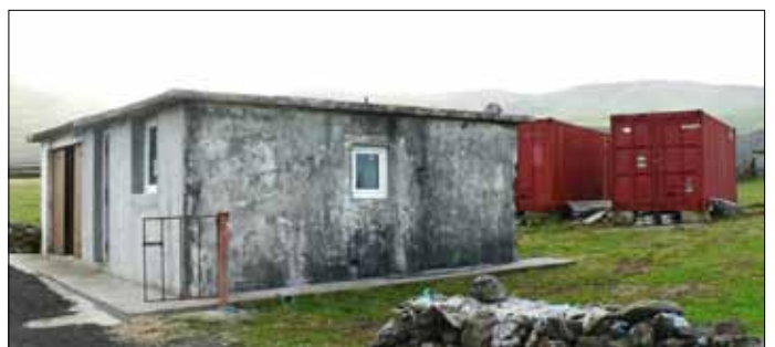
CU8AS-Shack mit 6m-Containern; Sturm verschob vollen Container um 0,5m!
